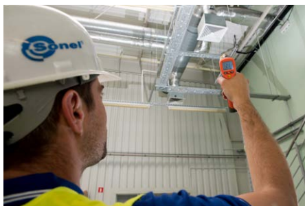
Hệ thống HVAC
